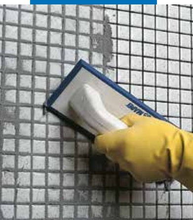
Remplissage des joints entre carreaux de pâte de verre à la spatule, dans une salle de bains
