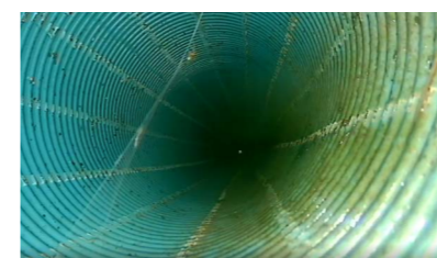
VUE INTÉRIEURE DE L'INFILTRATUBE
