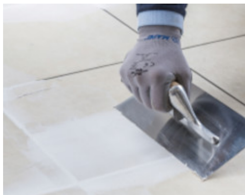
Ragrée et combler les joints sur un carrelage existant à l'aide de Planiprep 4 LVT
